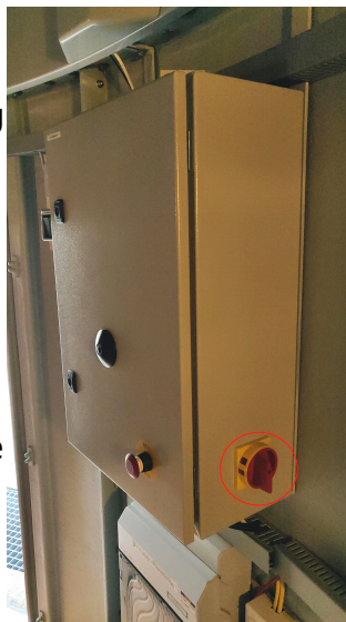
Abb. 1: Kuppelsteuerungskasten - rot: Hauptschalter
