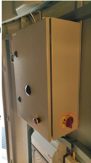
Abb. 1: Kuppelsteuerungskasten - rot: Hauptschalter
