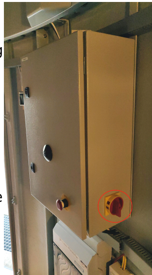
Abb. 1: Kuppelsteuerungskasten - rot: Hauptschalter
