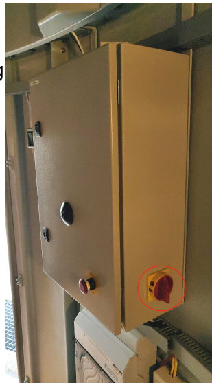
Abb. 1: Kuppelsteuerungskasten - rot: Hauptschalter
