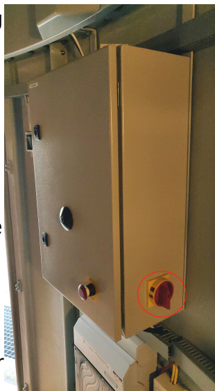
Abb. 1: Kuppelsteuerungskasten - rot: Hauptschalter
