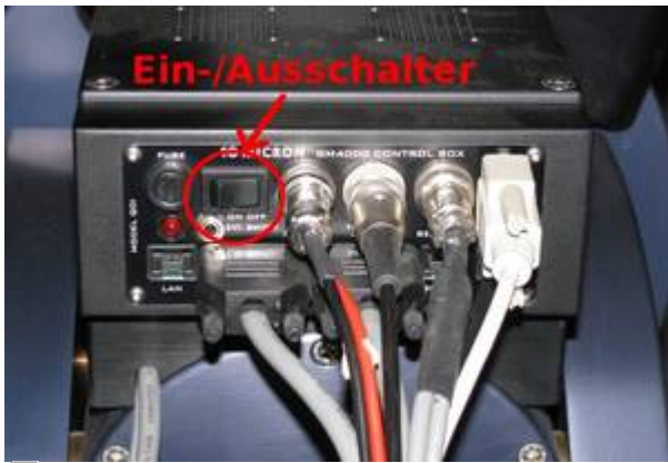
Steuereinheit an der Montierung
