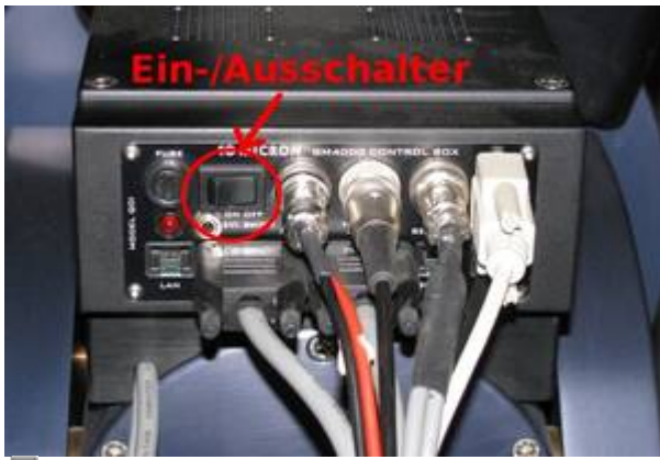
Steuereinheit an der Montierung
